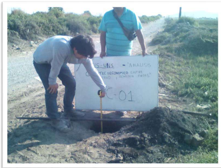
FOTO N° 01: Ubicación de la calicata C-01, presencia de relleno de 0.00 m a 0.60 m, de gravas bien graduadas de 0.60 a 1.20 y arenas con presencia de limo de 1.20 a 1.65
