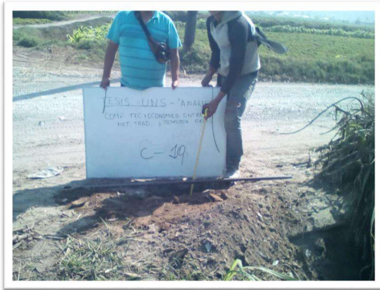
FOTO N° 17: Ubicación de la calicata C-17, presencia de relleno de 0.00 m a 0.15 m., con presencia de gravas y arena de 0.60 m. a 1.40 m.
