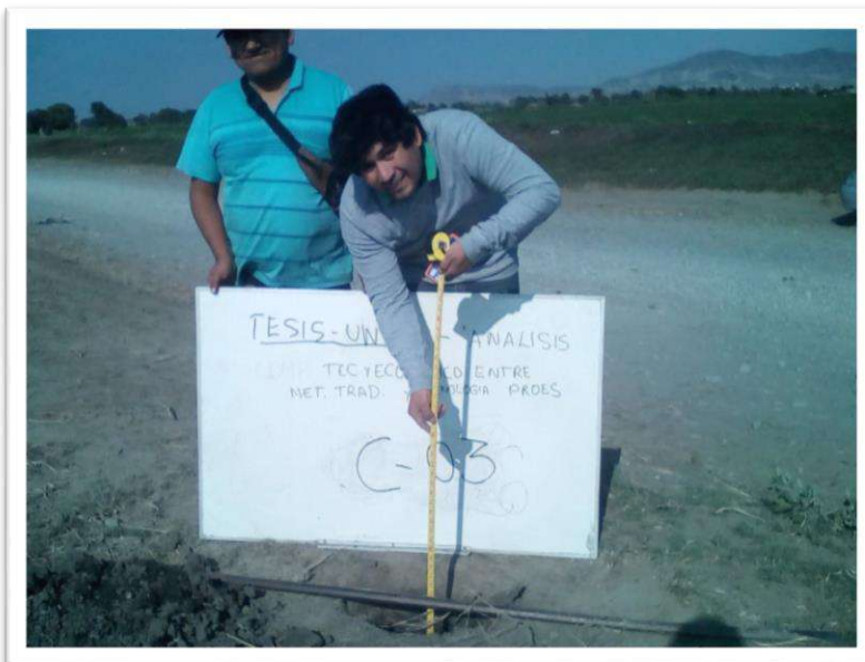
FOTO N° 02: Ubicación de la calicata C-03, El Suelo de 0.0 m a 0.20 m conformado generalmente por relleno, con presencia de gravas y arena de 0.20 m. a 1.00 m., presencia de arcilla y limos de 1.00 m. a 1.70 m.
