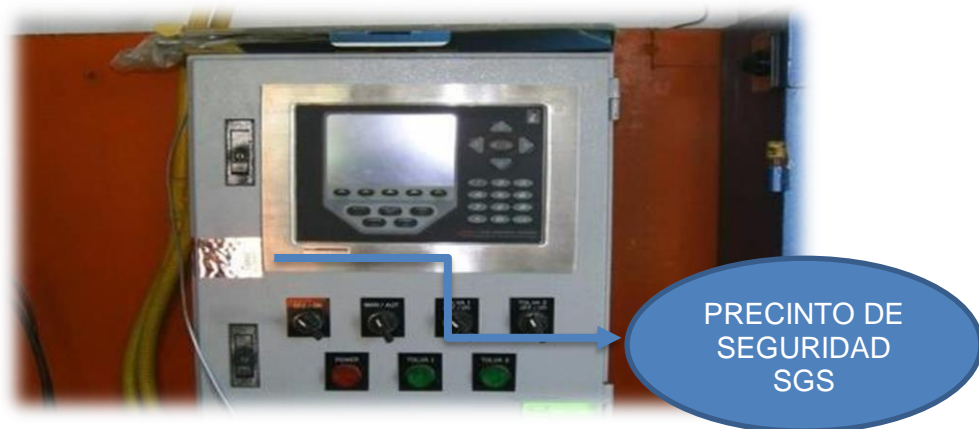
Fig. 20. Tablero de Control Eléctrico
