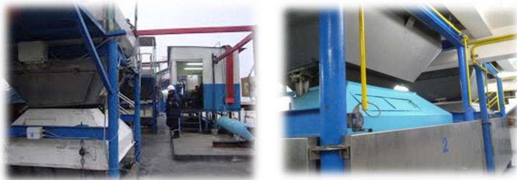
Fig. 24. Tolva de pesaje – Pesquera Cantabria S.A.C
