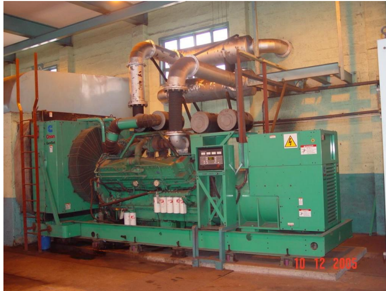
Figura 02: Grupo Electrónico con diésel Cummins de 1.5 MW
