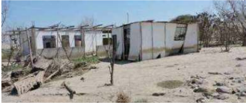
Figura 9: Vivienda rural destruida en el sector de la sub cuenca hidrográfica Chimbote.
