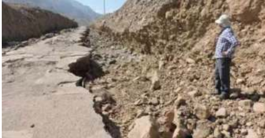
Figura 6: Dstrucción total de la carretera Casma – Huaraz, en el tramo Buena Vista Alta – Cachipampa.
