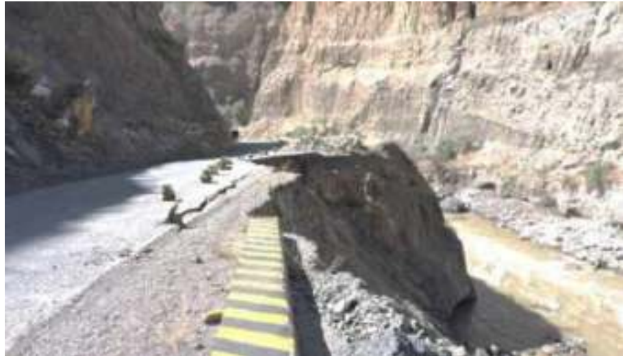
Figura 8: Daños en la pista por erosión de una ladera ubicada sobre la margen izquierda del río Santa. Vista tomada hacia el Noreste.
