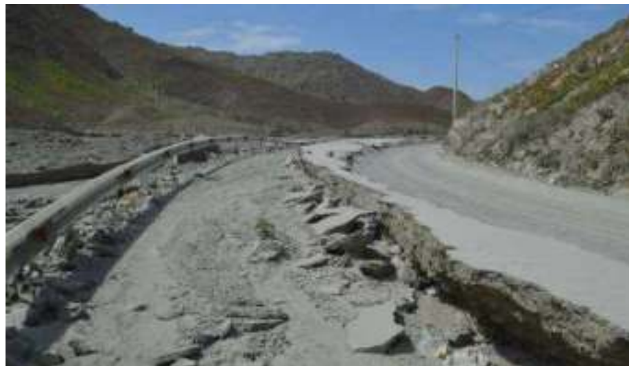
Figura 7: Daños ocasionados por flujos de detritos y lodo.
