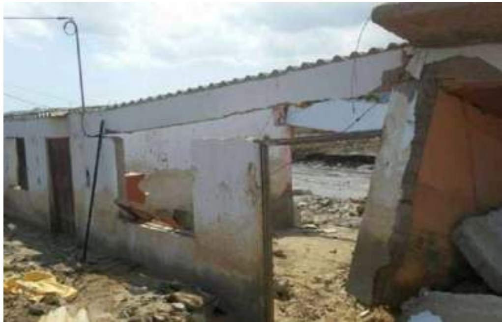
Figura 11: Viviendas en escombros, afectadas por los desbordes.
