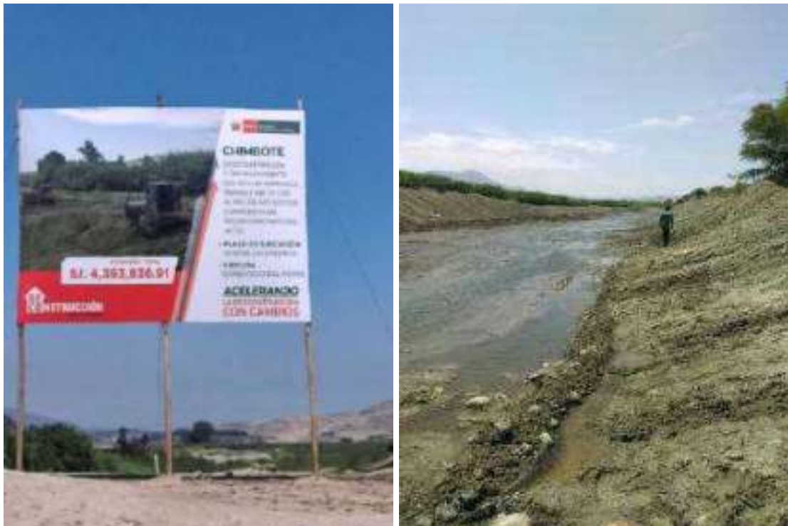
Figura 71 y Figura 72: A inicios del 2018 se realizaron trabajos de descolmatación y encauzamiento en el río Lacramarca.
