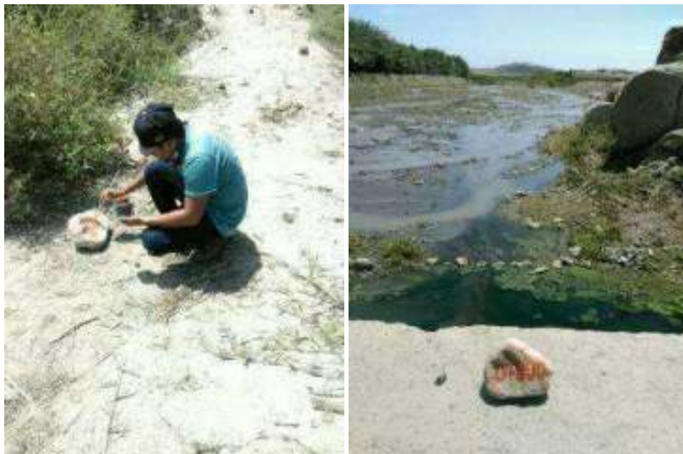
Figura 75 y Figura 76: Una vez identificada la zona, se procedió a realizar el estudio de topografía, para lo cual se determinó que el punto inicial sería un badén existente que conecta el CP Chachapoyas y el CP Villa María, marcando las progresivas desde la 0+000.
