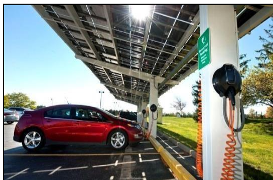
Figura 19. Parqueadero para vehículos eléctricos.
