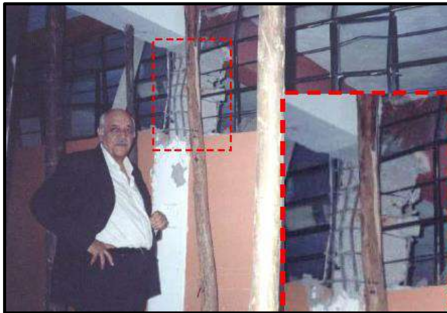
Figura 30: Falla de columna corta en colegio local, Sismo de Moquegua del 2001
