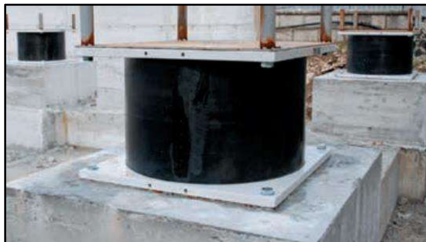
Figura 48: Instalación de aisladores LRB en la Escuela secundaria “G.Lombardo Radice” de Italia
