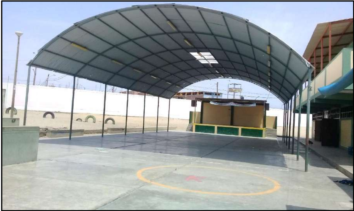
Fotografía N°17: Se aprecia un patio y un escenario para diferentes actividades, sobre estos se observa un techo compuesto por una estructura metálica.
