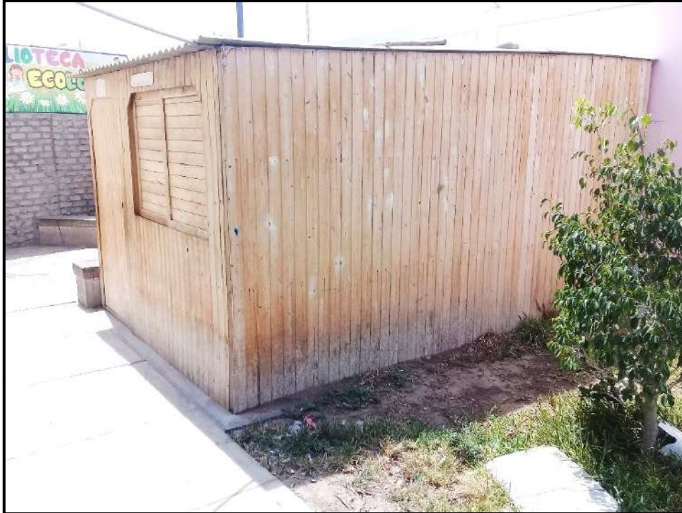
Fotografía N°11: Se observa esta construcción de madera que es usado por Qali Warma, ubicado a la derecha del Pabellón “C”.
