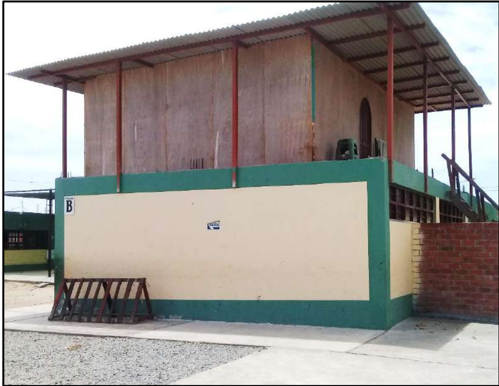
Fotografía N°07: Se observa encima del Pabellón “B” esta estructura de madera usado como depósito para guardar libros que se llega a través de una escalera.
