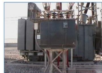
Transformador de 35 MVA – 220 kV
