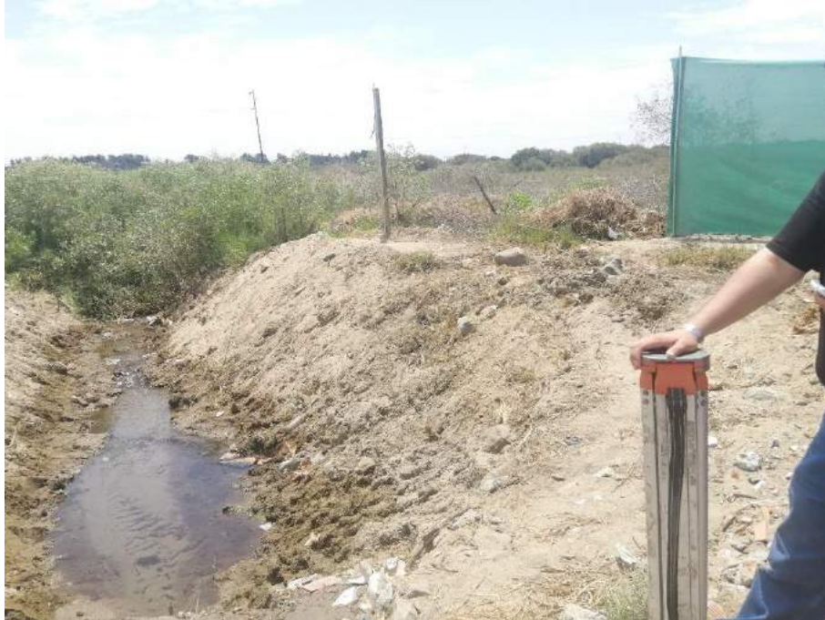
Foto 07.- afloramiento de Nivel freático en fondo de Dren abierto
