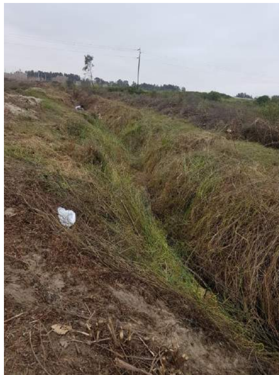
Foto 04.-Dren a zanja abierta el cual será cambiado por dren con tubería.
