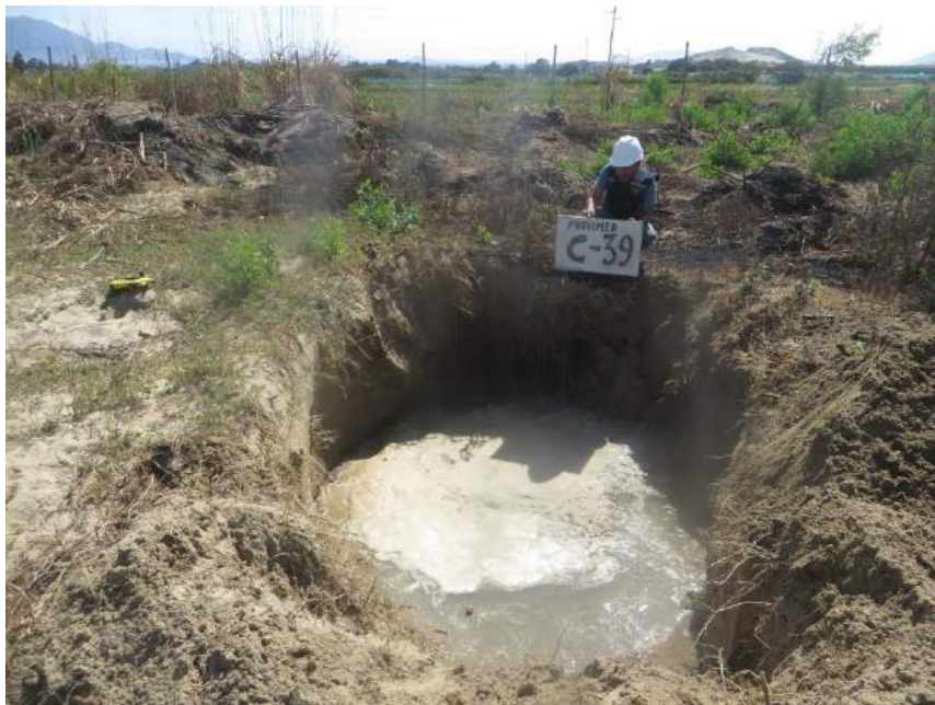
Foto 10.- Excavación de calicata donde se aprecia el nivel freático elevado
