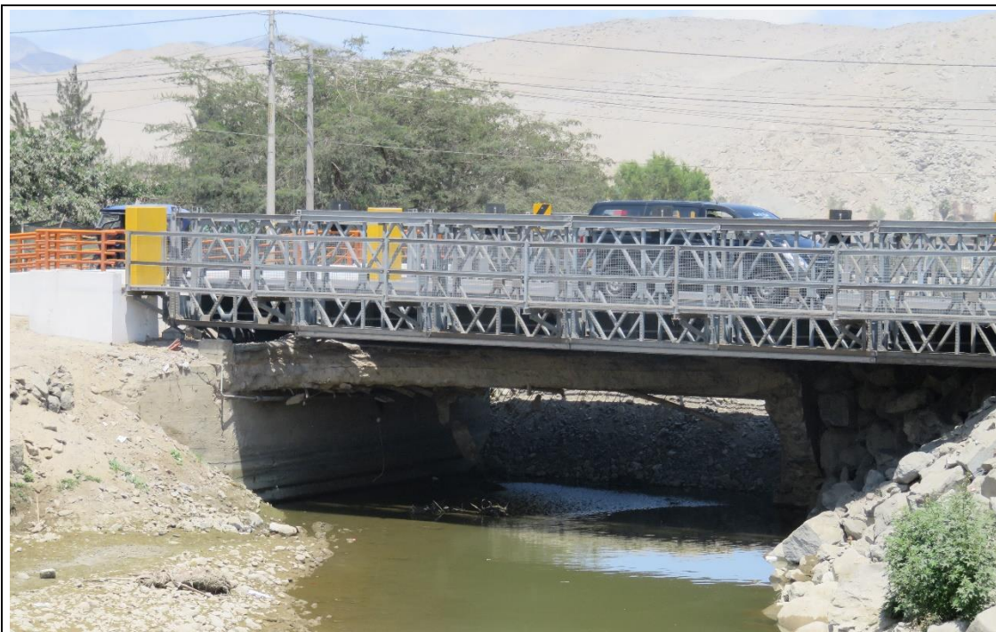
FOTO N° 03: Se observa el Puente Sechín aguas arriba con flujo en la fecha 14 de septiembre del año 2017.
