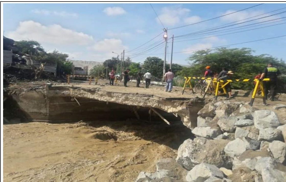
FOTO N° 01: Se observa el Puente Sechín que colapsó por el desborde del río que lleva el mismo nombre en la fecha 17 de Marzo del año 2017.
