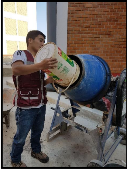
Foto 9: Realizando el procedimiento de laboratorio para el mezclado del concreto en el trompo.
