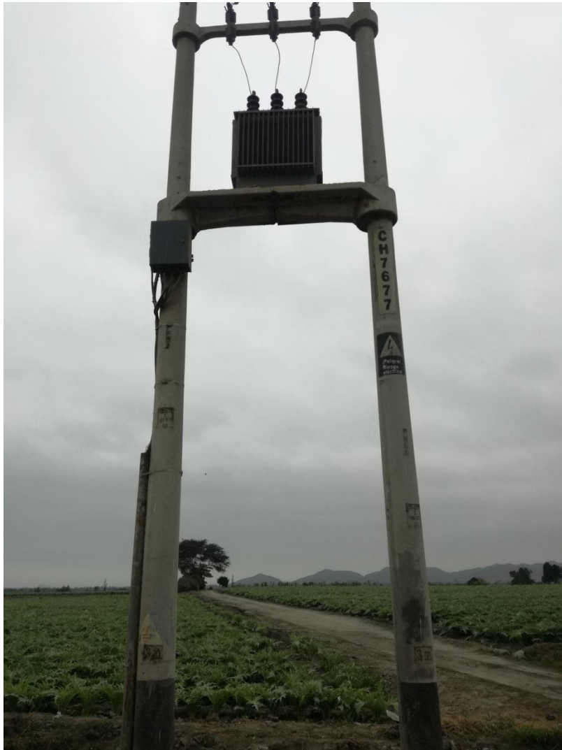
Foto N° 5: Subestación eléctrica en media tensión
