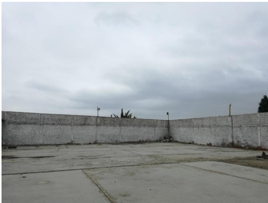
Foto N° 2 : Vista perimétrica de Iluminación en baja tensión.
