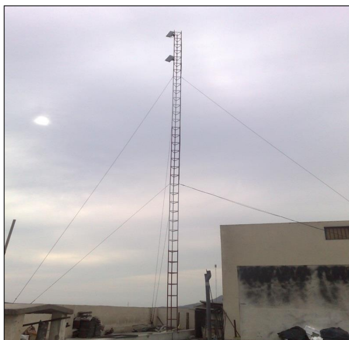
Fig N° 35: Torre y Antena instalada en Sede Central
