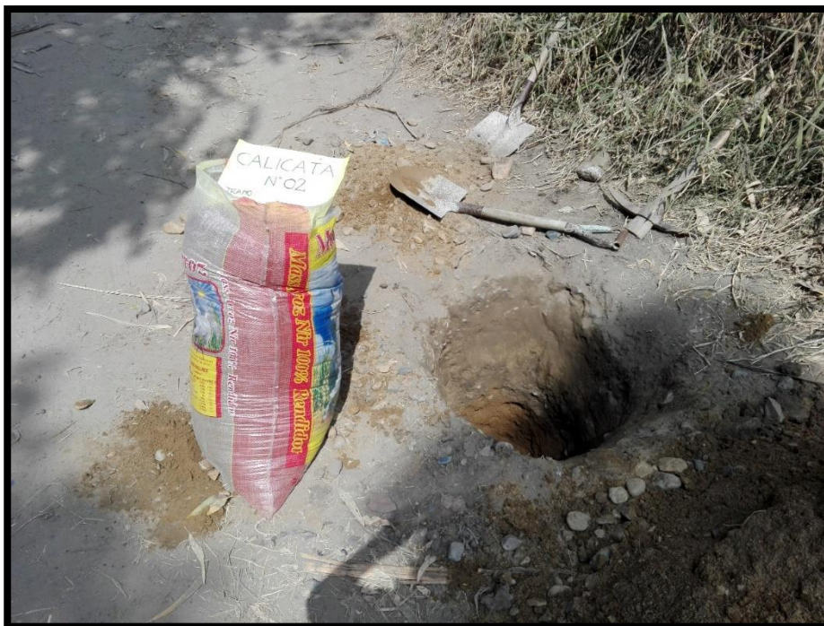
Figura N°02: Excavación y toma de muestra de suelo de la calicata C-02 en la vía Santa Clemencia – Chachapoyas.
