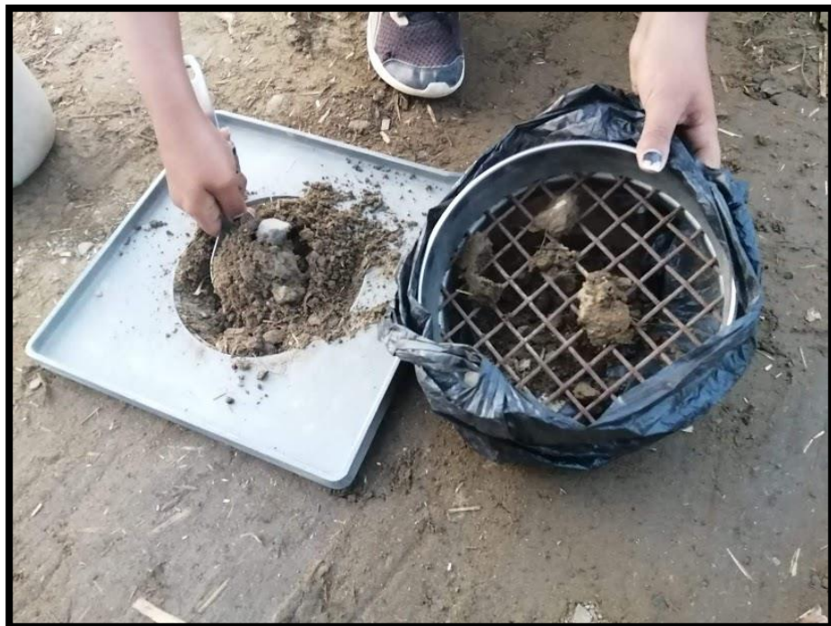
Figura N°29 y 30: Realización del ensayo de densidad de campo in situ, en la vía Santa Clemencia – Chachapoyas (MTC E 117).
