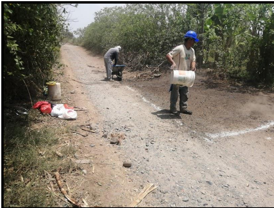
Figura N°21 y 22: Humectación del suelo de subrasante después de la escarificación del material hasta llevarlo a una condición de \pm 2\% con respecto a la humedad óptima de compactación obtenida en laboratorio.
