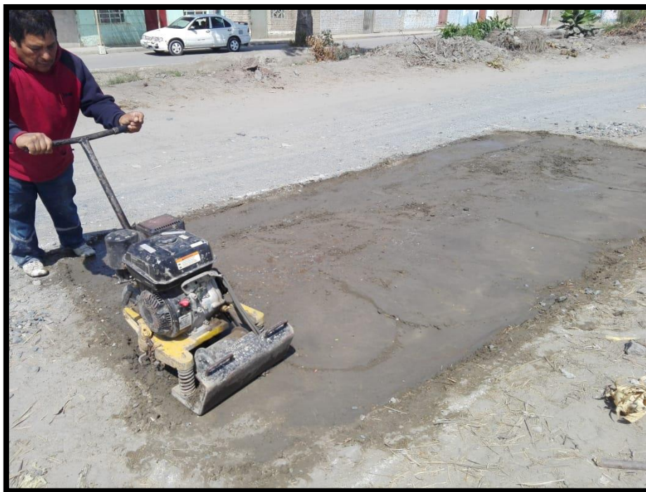
Figura N°25 y 26: Compactación del área de prueba con 01 plancha compactadora. La superficie terminada del tramo de subrasante no presenta deformaciones ni altibajos.
