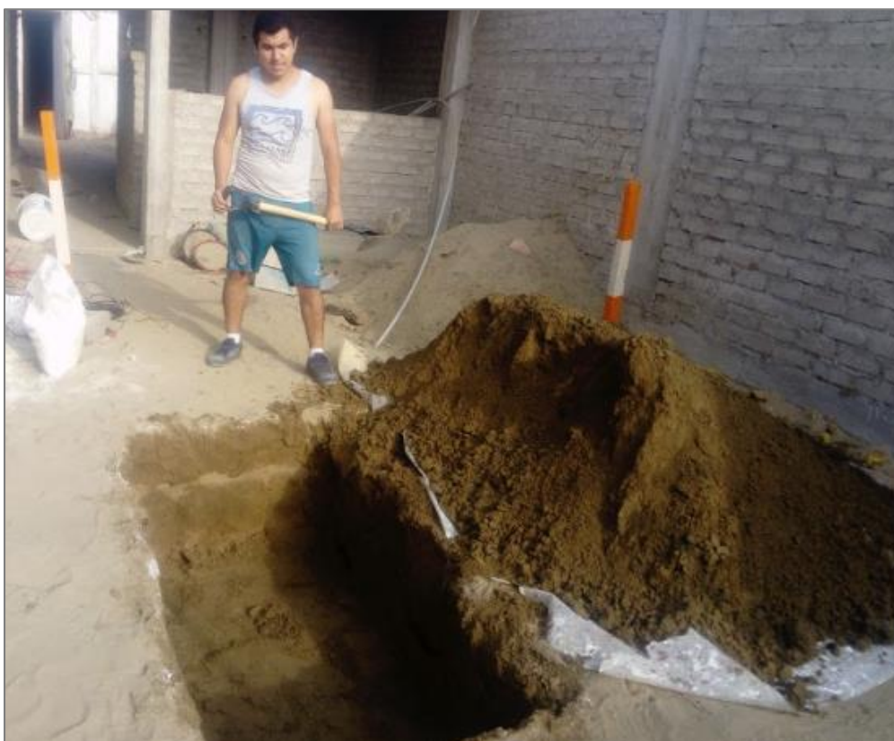
Figura N o 13.- Excavación de la zanja de dimensiones 2m x 1m x 0.5 m para realizar la prueba con bentonita.
