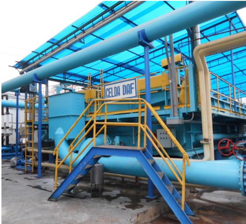
Figura 13: Celda DAF de la planta Copeinca Chancay.
