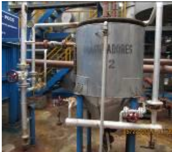
Figura 15: Tanque coagulador de la planta Copeinca Chancay.
