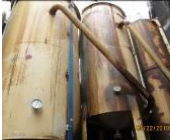
Figura 14: Precoaguladores de la planta Copeinca Chancay.
