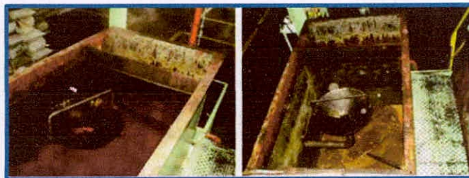
Figura N°04: Sistemas de Colectores de Aceite.
