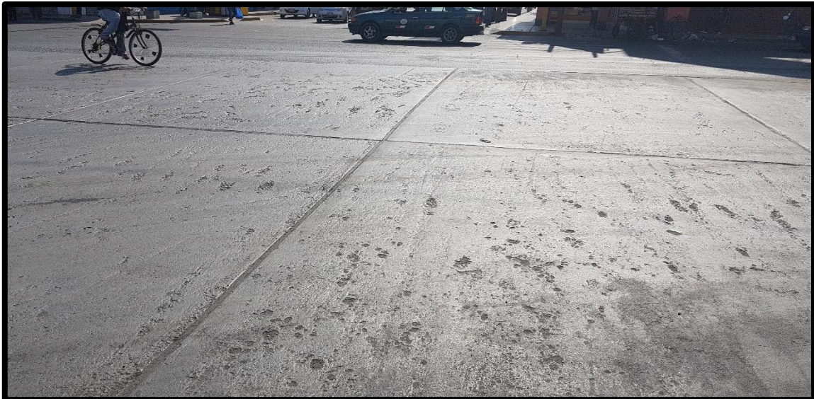
FOTO N° 12: Falla Pérdida de Áridos, en el Pavimento Rígido del Jr. Alfonso Ugarte con Av. José Gálvez.
