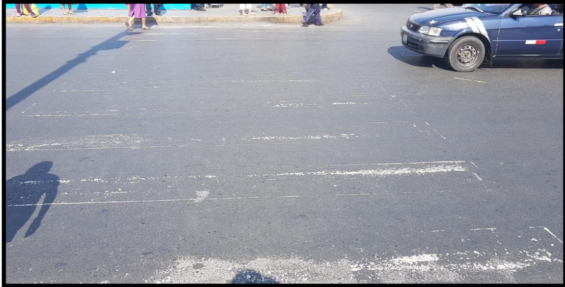
FOTO N° 13: Desgaste de paso peatonal en la intersección Jr. Ladislao Espinar con Av. José Gálvez.
