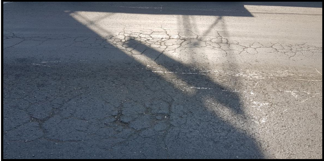
FOTO N° 11: Falla Piel de Cocodrilo encontrada en el Pavimento flexible del Jr. Alfonso Ugarte con Av. José Gálvez.
