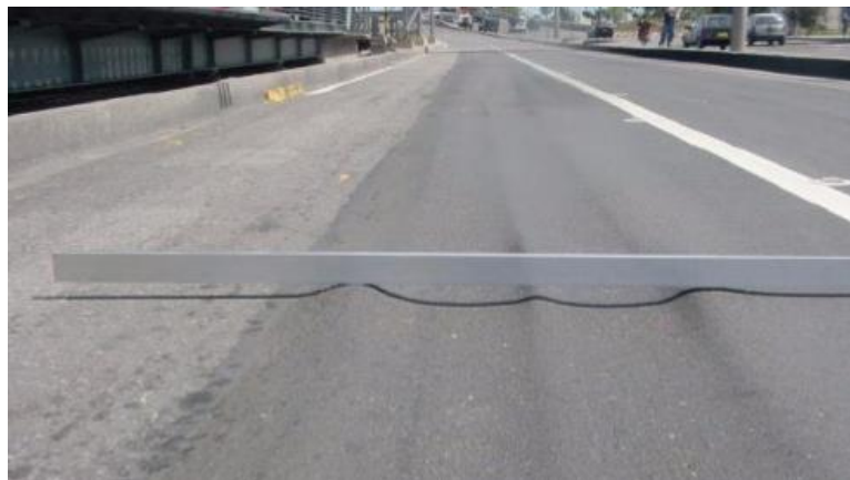
Figura 10: Ahuellamiento - Nivel de gravedad 3
