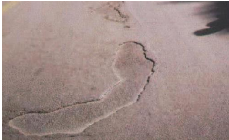
Figura 12: Peladura y desprendimientos - Nivel de gravedad 2
