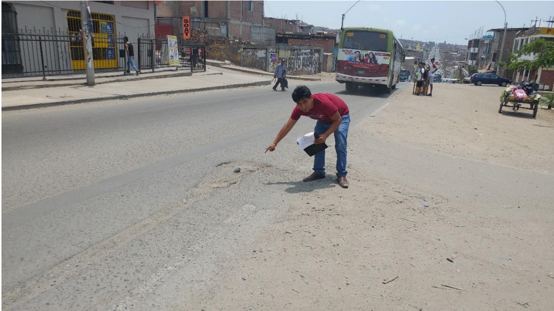
Figura 47: Baches en la estructura del Pavimento. Nivel de gravedad 3, diámetro > 0.5m
