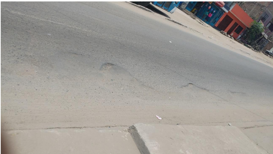
Figura 46: Ahuellamiento presente en la Av. Miguel Iglesias – Tramo 01
