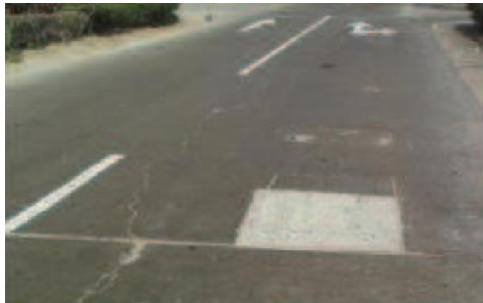
Figura 19: Reparaciones en pavimentos rígidos - Nivel de gravedad 1
