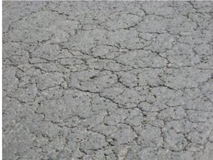
Figura 5: Piel de cocodrilo - Nivel de gravedad 2
