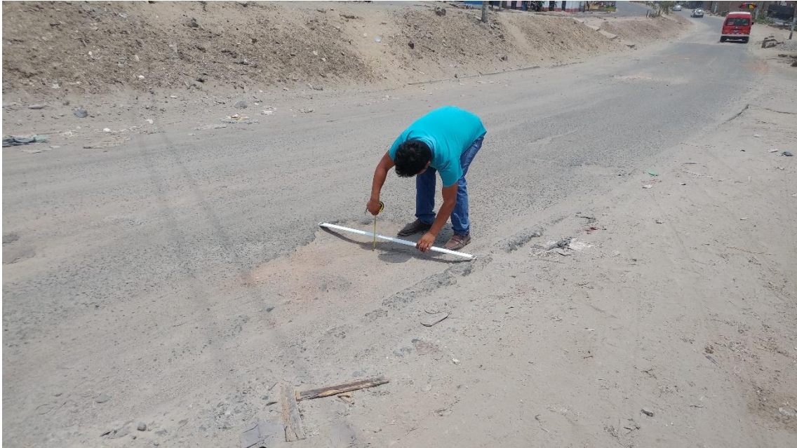
Figura 51: Verificación de los niveles de gravedad de los baches a lo largo de la vía
