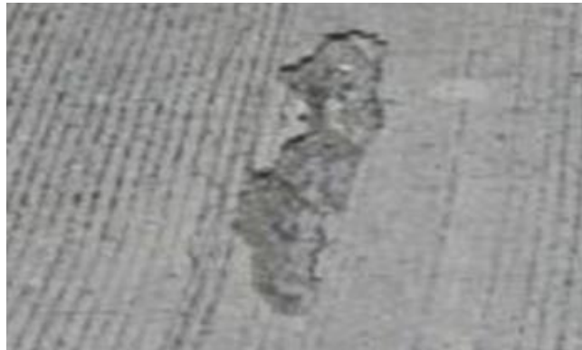
Figura 21: Pérdida del material en la superficie de la losa - Nivel de gravedad 1
