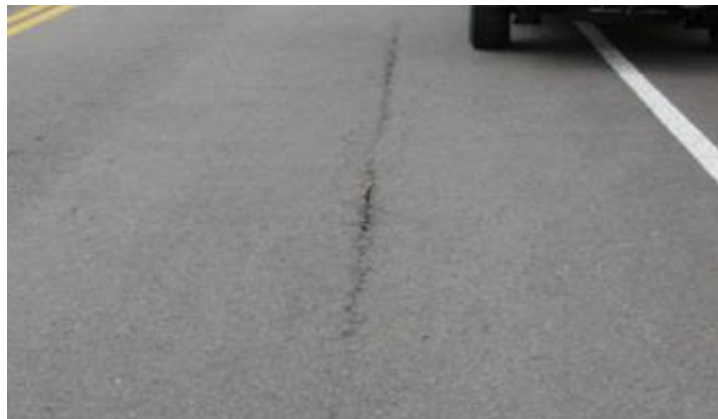
Figura 7: Fisuras longitudinales - Nivel de gravedad 2
