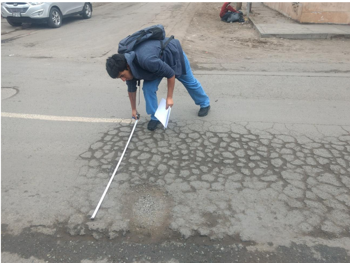
Figura 52: Toma de datos de las dimensiones de la falla de piel de cocodrilo
