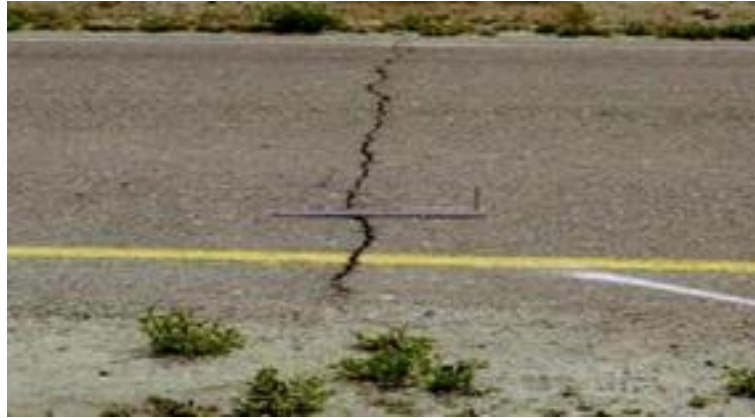
Figura 14: Fisuras transversales - Nivel 3
