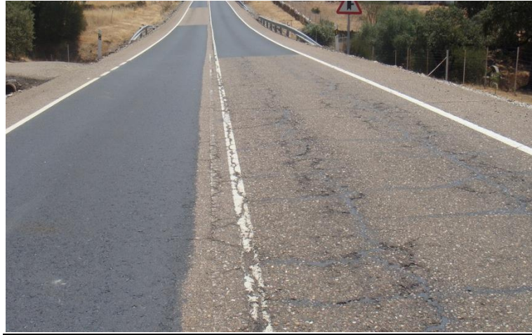
Figura 11: Reparaciones o parchados de piel de cocodrilo - Nivel de gravedad 3
