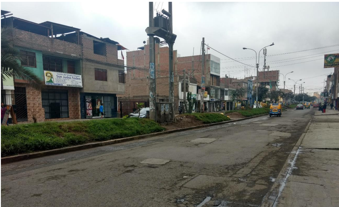
Figura 54: Presencia de tramos parchados a lo largo de la vía en el sector 1
