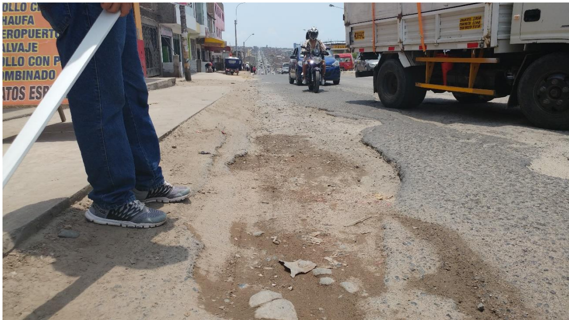
Figura 48: Desprendimiento total de una parte de la carpeta asfáltica en la Av. Miguel Iglesias, Nivel de gravedad 3 en el Sector 2
