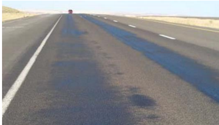
Figura 15: Exudación - Nivel de gravedad 3
