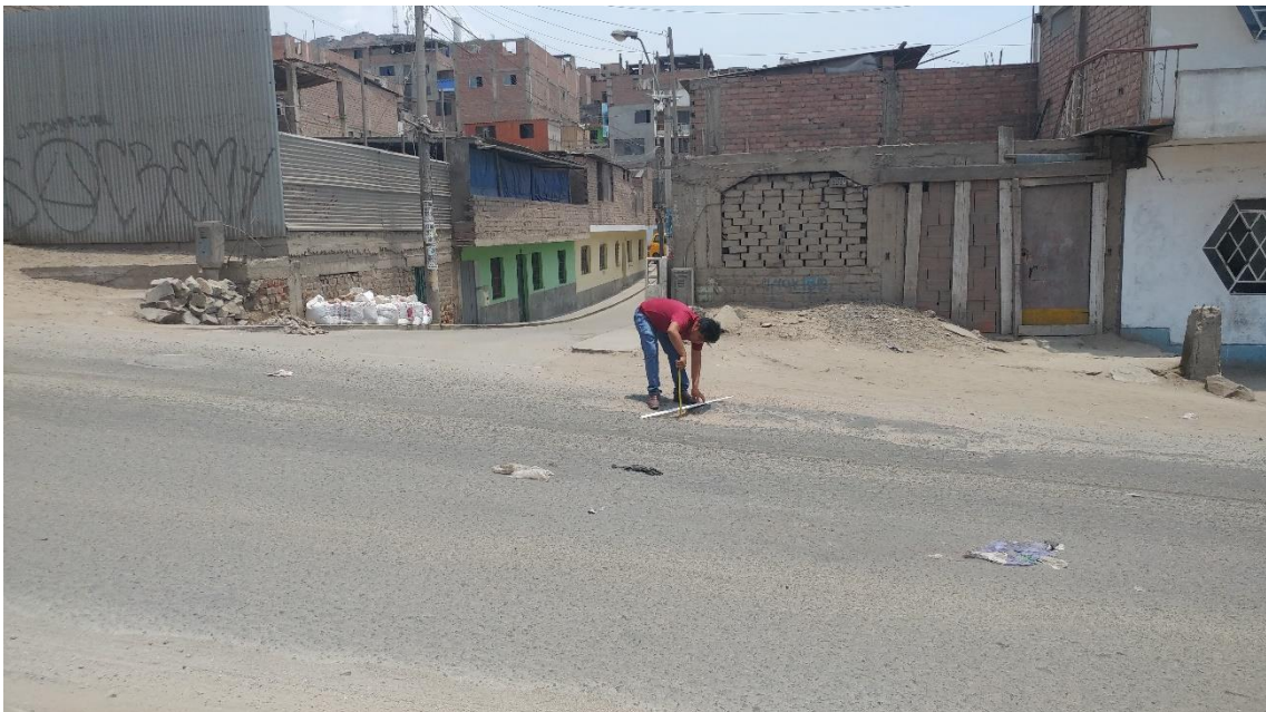
Figura 44: Deformación por deficiencia estructural Nivel 3 en la Av. Miguel Iglesias – Tramo 02
