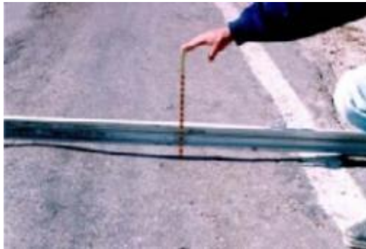
Figura 9: Deformación por deficiencia estructural - Nivel de gravedad 2
