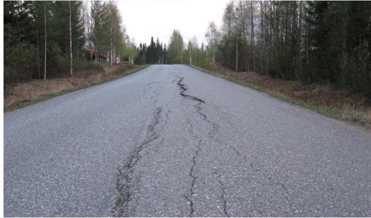
Figura 8: Fisuras longitudinales - Nivel de gravedad 3
