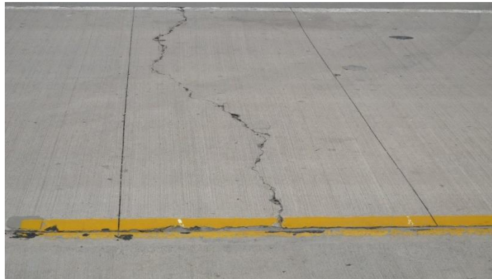
Figura 16: Fisuras transversales en pavimentos rígidos - Nivel de gravedad 3
