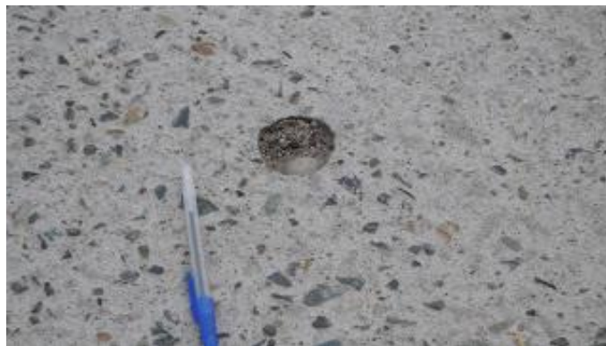
Figura 22: Baches en pavimentos rígidos - Nivel de gravedad 1
