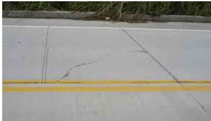
Figura 18: Fisuras oblicuas en pavimentos rígidos - Nivel de gravedad 2
