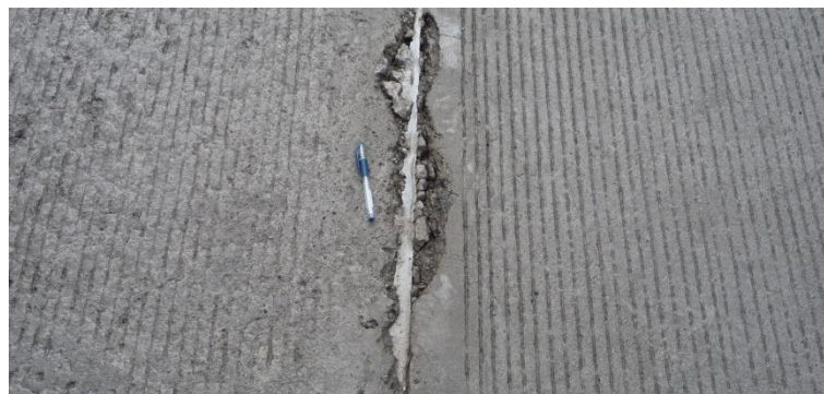
Figura 20: Fracturamiento o desintegración en juntas - Nivel de gravedad 3
