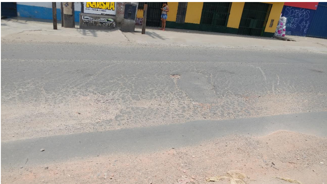
Figura 50: Presencia de piel de cocodrilo y desprendimiento de la carpeta asfáltica en el Sector 2, Nivel de gravedad 2
