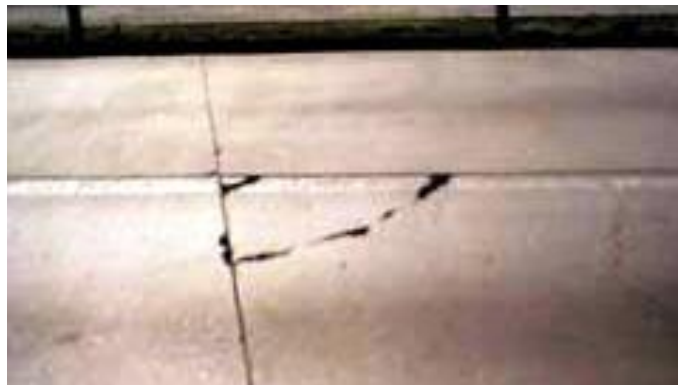
Figura 17: Esquina quebrada - Nivel de gravedad 3
