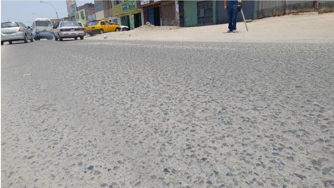
Figura 49: Desprendimiento de la carpeta asfáltica en la Av. Miguel Iglesias, Nivel de gravedad 1 en el Sector 3
