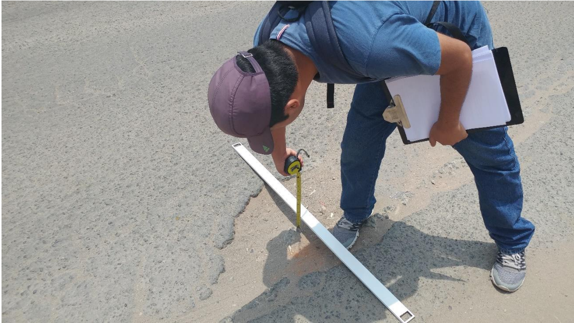
Figura 43: Deformación por deficiencia estructural Nivel 3 en la Av. Miguel Iglesias
