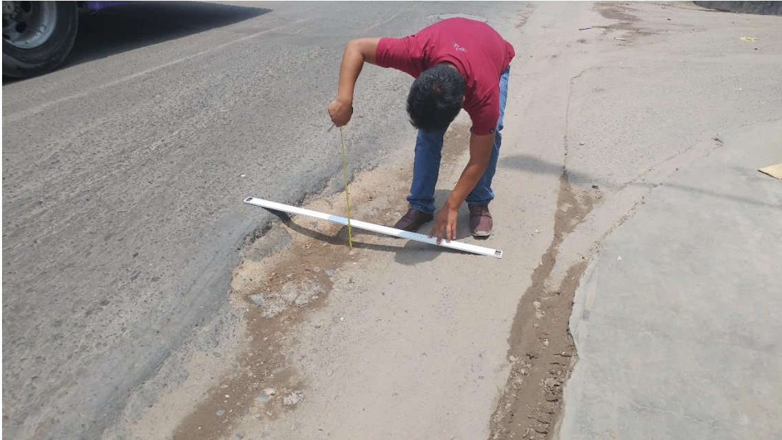
Figura 45: Deformación por deficiencia estructural Nivel 3 en la Av. Miguel Iglesias – Tramo 01
