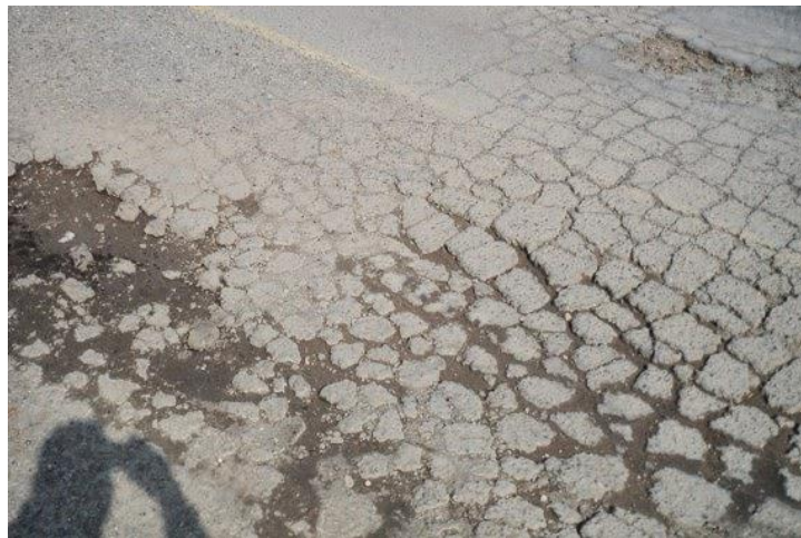
Figura 6: Piel de cocodrilo - Nivel de gravedad 3
