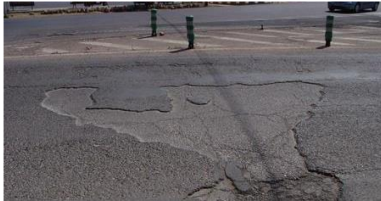
Figura 23: Desprendimiento en la superficie de la losa - Nivel de gravedad 3
