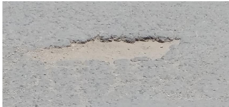
Figura 13: Baches - Nivel de gravedad 2
