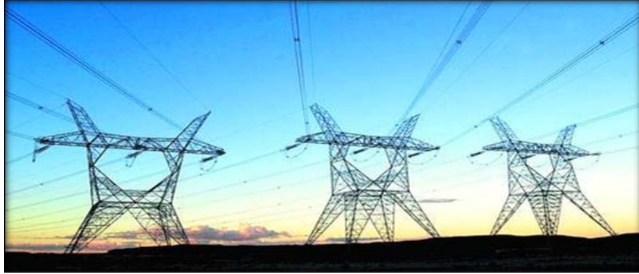
Figura No.5. Torres de Alta Tensión
