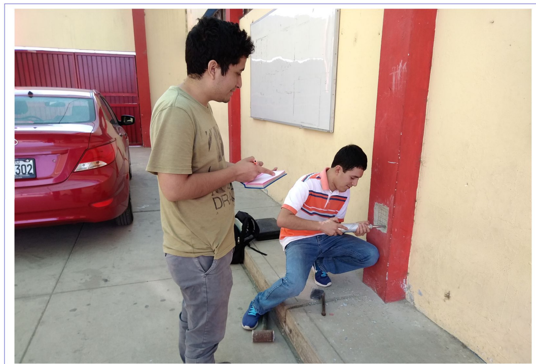
FOTO N° 18 TOMA DE ENSAYO SOBRE OTRA COLUMNA
