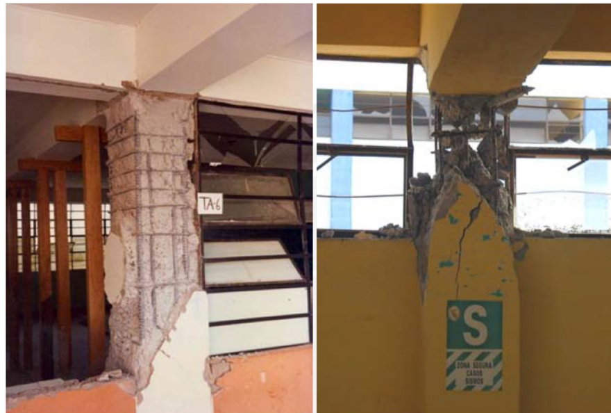
Figura 2.29. Falla por columna corta en edificios escolares tipo 780 pre NDSR-1997 FUENTE: Astorga y Aguilar, 2006
