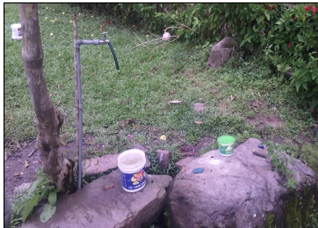
Figura 64 Vista de las conexiones domiciliarias en la localidad de Alizo
