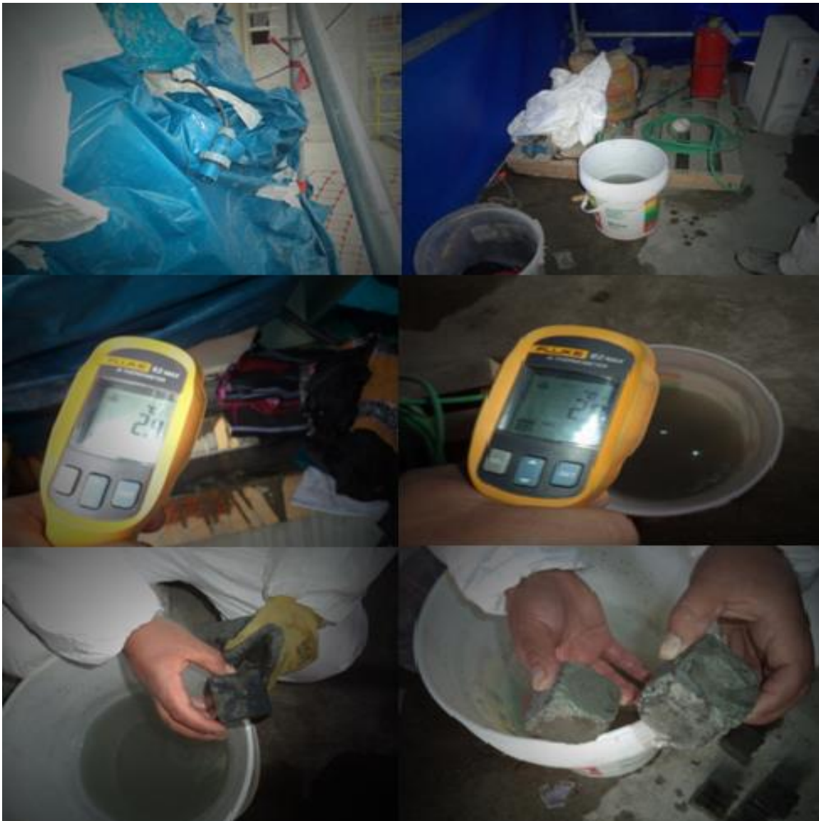
Ilustración 24 Registro visual de lesiones en el grout (obra)
