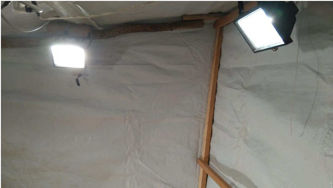
Ilustración 36 Reflectores de 500 W (procedimiento constructivo del tesista).
