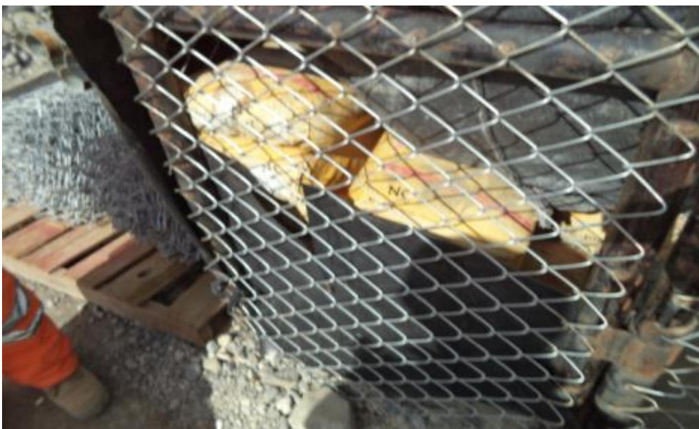
Ilustración 26 Registro visual de lesiones en el grout (obra)
