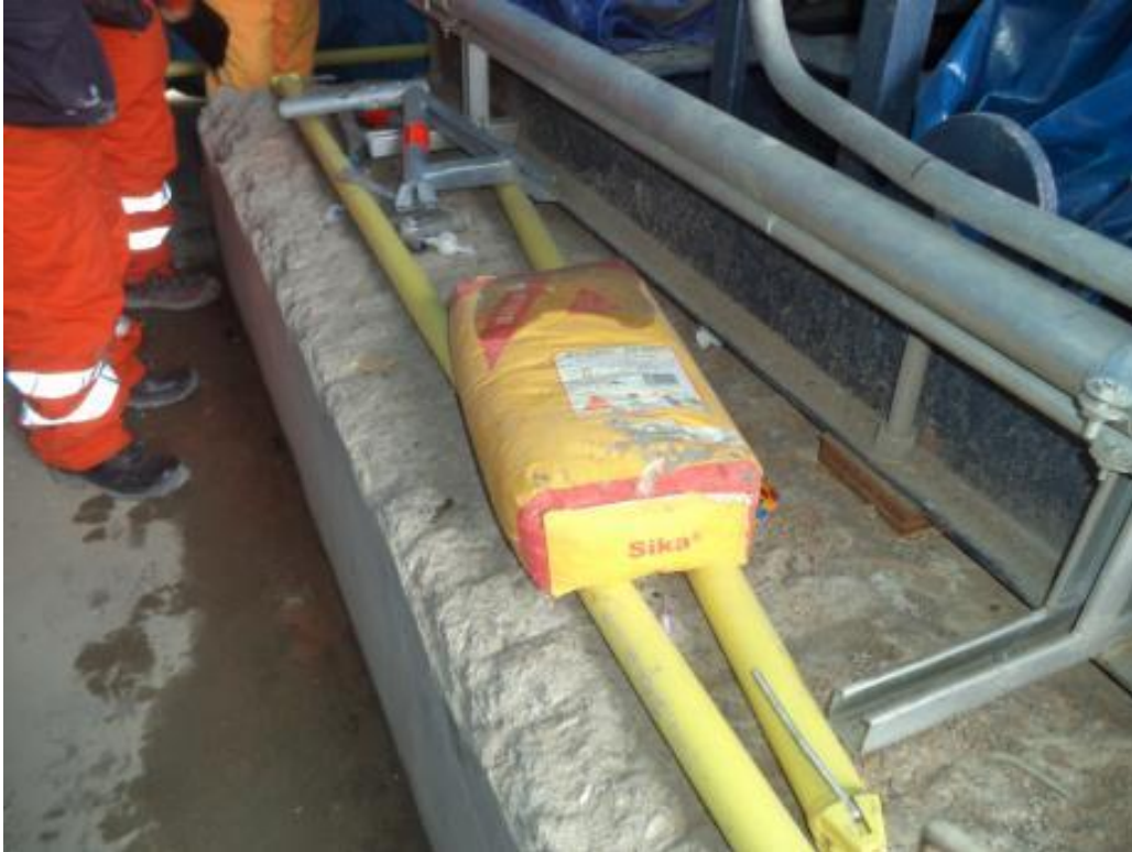
Ilustración 27 Material expuesto, no almacenado correctamente (obra)
