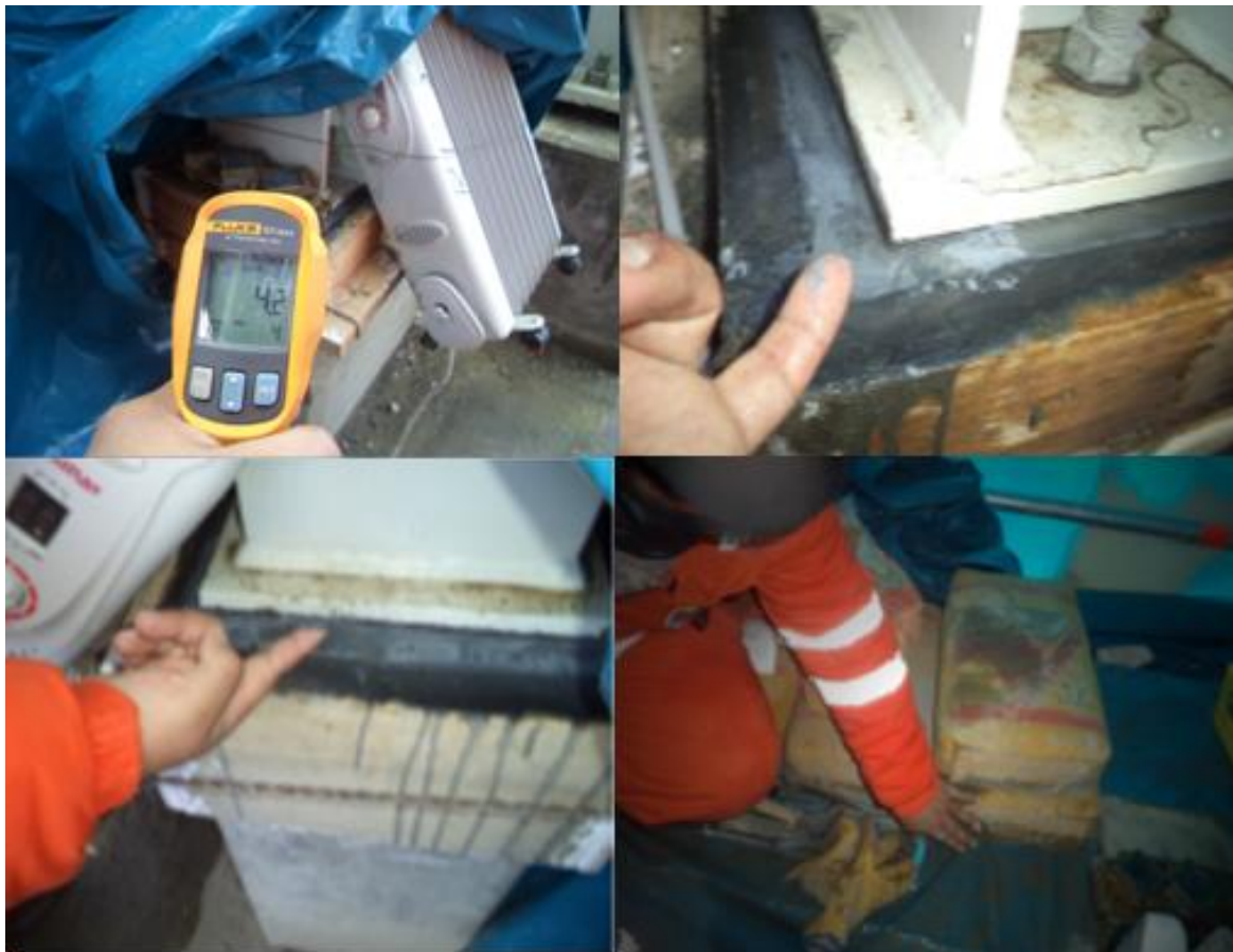
Ilustración 23 Registro visual de lesiones en el grout (Obra)
