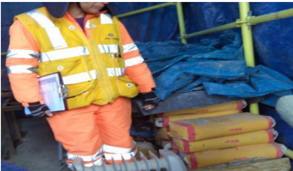
Ilustración 28 Material expuesto, no almacenado correctamente (obra)
