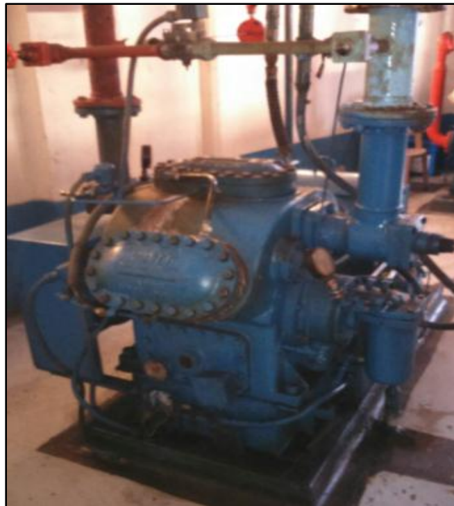
Anexo 2.10: Compresor Vilter Fuente: Área de Mantenimiento
