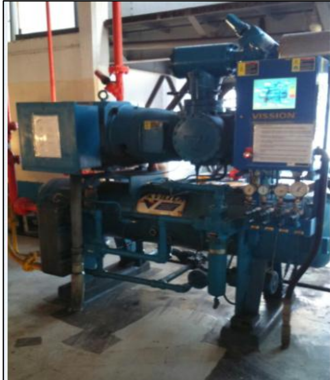
Anexo 2.9: Compresor Vilter Fuente: Área de Mantenimiento
