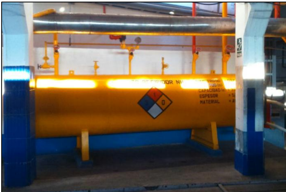
Anexo 2.8: Recipiente de Amoniaco Fuente: Área de Mantenimiento
