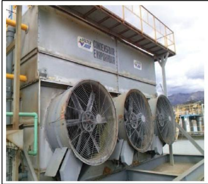
Anexo 2.1: Condensador evaporativo 1 Fuente: Área de Mantenimiento
