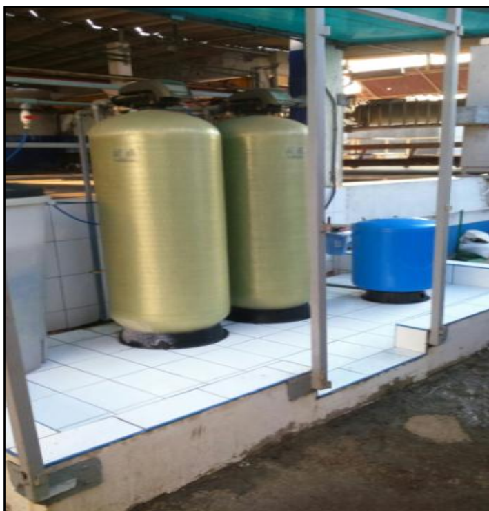
Anexo 2.5: Sistema de ablandamiento de Agua Fuente: Área de Mantenimiento
