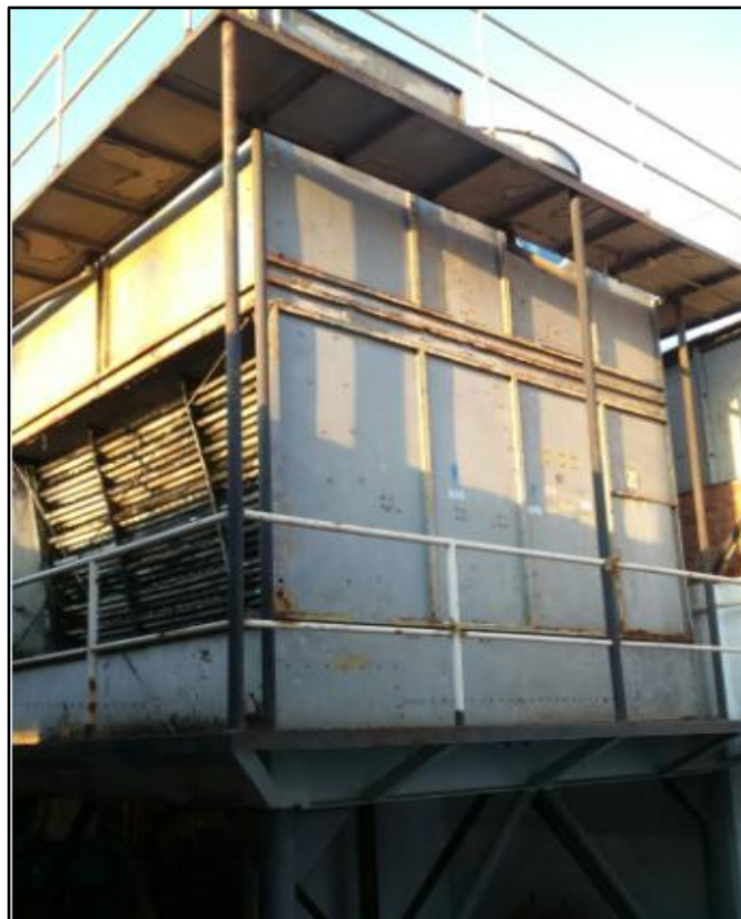
Anexo 2.2: Condensador Evaporativo 2 Fuente: Área de Mantenimiento
