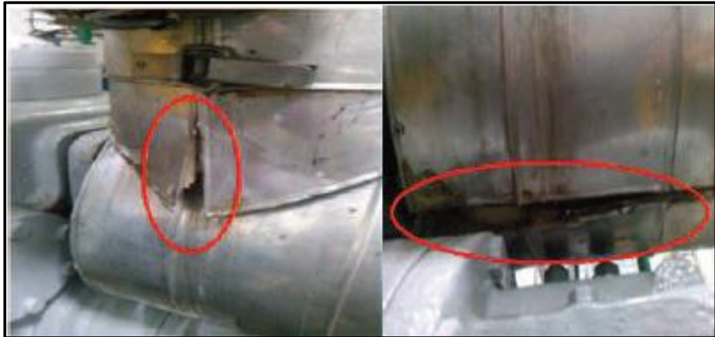
Anexo 2.11: Anomalías de aislamiento de tuberías Fuente: Área de Mantenimiento
