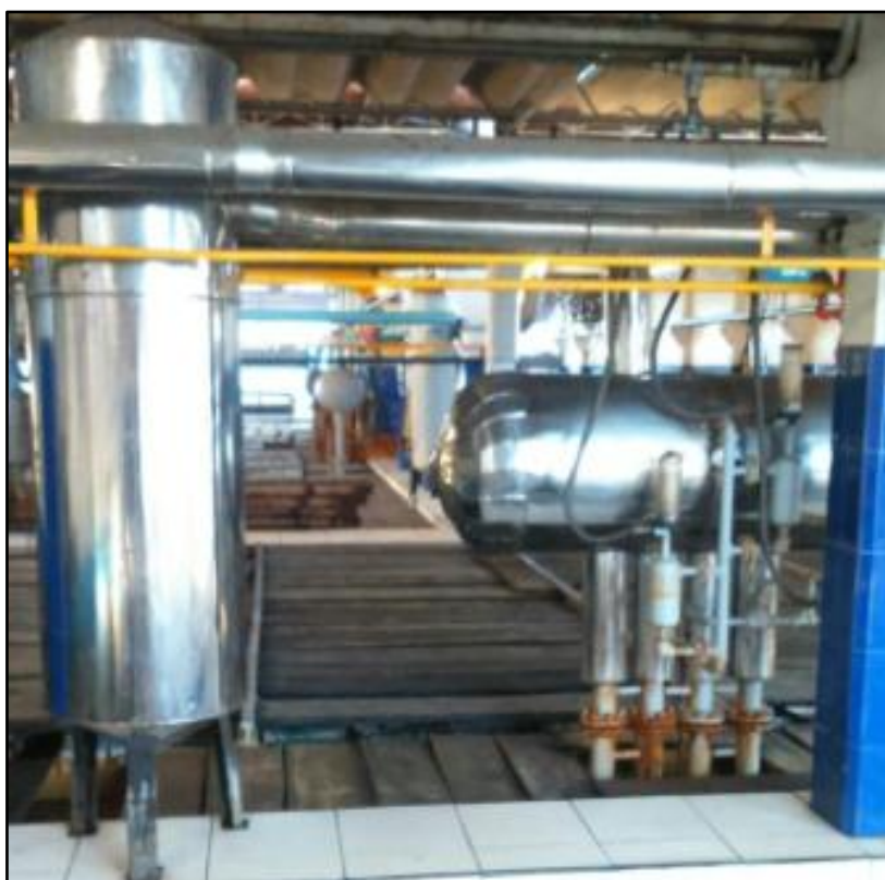
Anexo 2.6: Interfriador y recipiente de almacenamiento Fuente: Área de Mantenimiento
