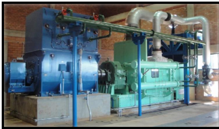
FIGURA N°04: Turbogenerador TGM/ WEG 21.7 kW
