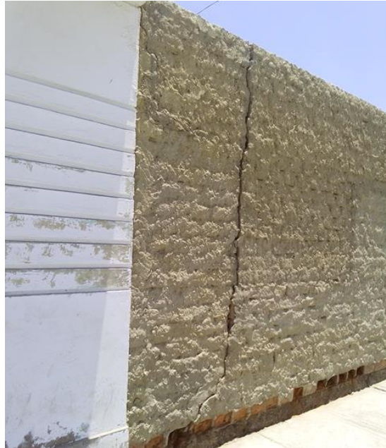
Fig. 4.14 Muro agrietado, ausencia de confinamiento (Jr. Angamos Ñ-6, F.A.)
