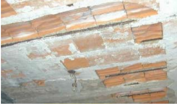
Acero corroído de aligerado
