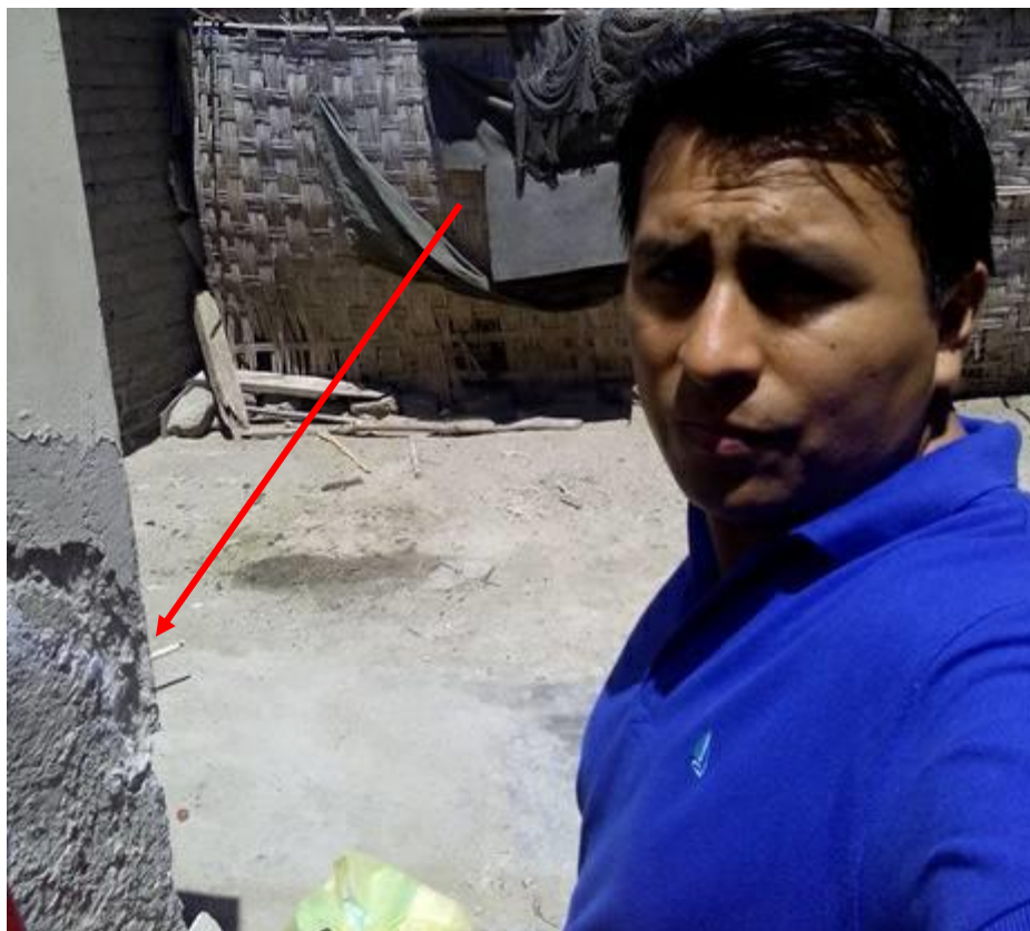
Fig. 4.10 Presencia de salitre en vivienda de Mz A-11 en F.B
