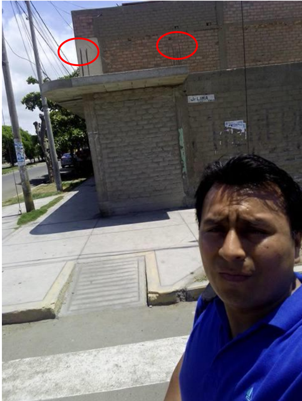
Fig. 4.19 Acero desprotegido en vivienda. (Jr. Lima Mza A, F.A)
