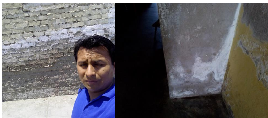
Fig. 4.17 presencia de salitre en el interior y exterior de viviendas. (Jr. Huánuco H-24, F.A)
