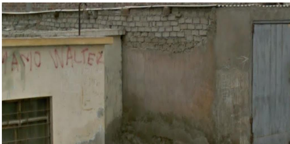
Fig. 4.12 Evidente ausencia de muros en sentido paralelo a fachada (Jr. Huancavelica F.B.)
