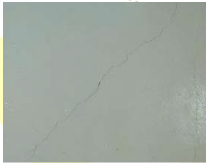
Grieta en muro
