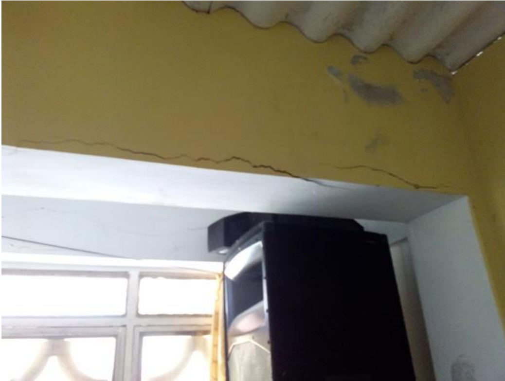
Fig. 4.6 Fisura por asentamiento sobre suelo arenoso (Jr. Huánuco H-24)
