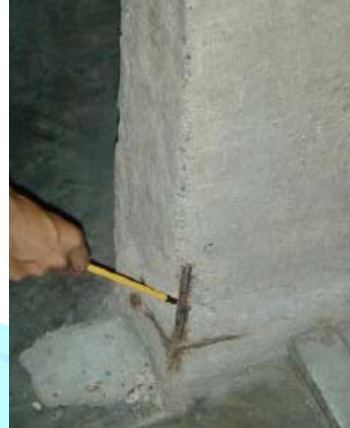
Acero corroído de columna
