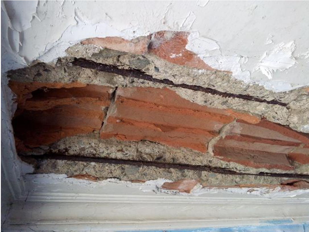
Fig. 4.15 Acero corroído en acero de losa aligerada. (Jr. Huánuco H-23B, F.A)
