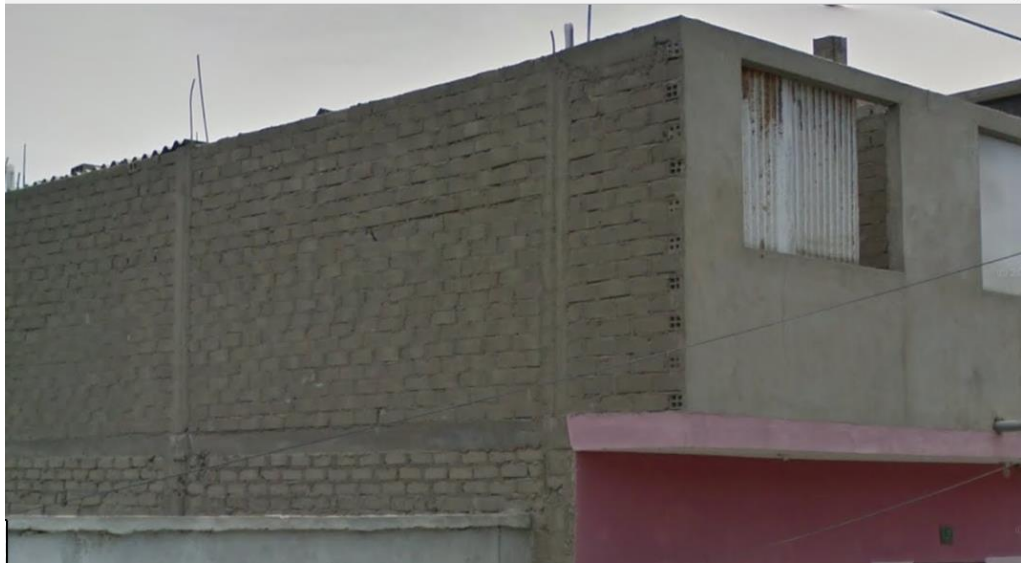
Fig. 4.14 Vivienda con muros portantes de ladrillo pandereta. ( Ps.j Tupac Amaru A-39)
