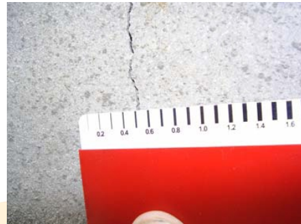
Espesor de la grieta
