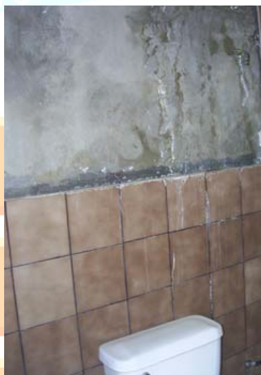
Humedad en muro de baño
