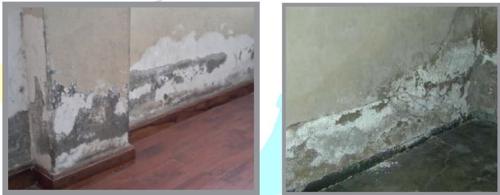
Eflorescencia en muros
