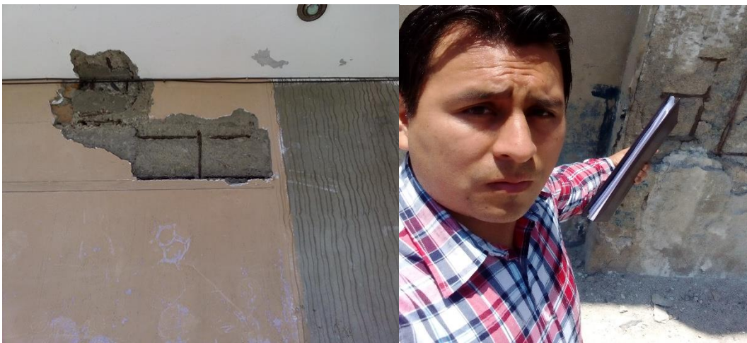
Fig. 4.16 Corrosión en armaduras de vigas y columnas. (Jr. Lima B-23. F.A)
