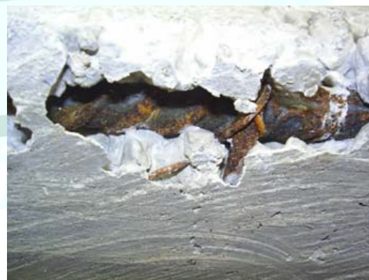
Acero de refuerzo corroído
