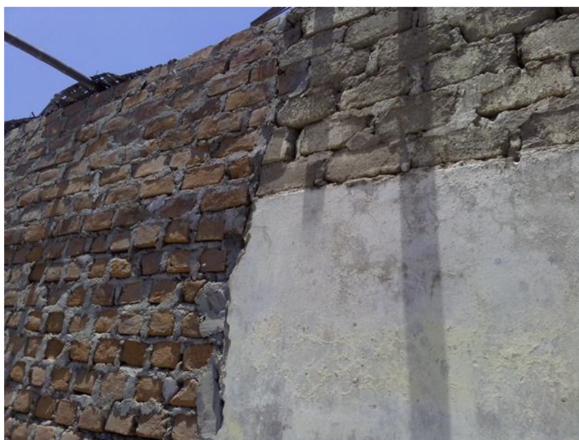
Fig. 4.18 Uso de ladrillos artesanales de mala calidad y levantamiento de muro deficiente.
