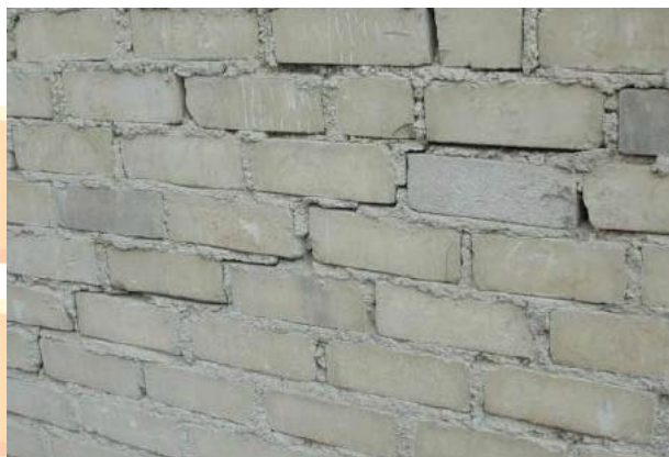
Grieta de espesor mayor 1.5 mm.
