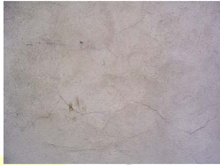
(grieta en tarrajeo)
