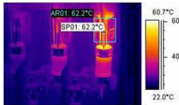
Figura 12. Imagen de infrarrojos de una caja de fusibles que muestra la temperatura máxima.
