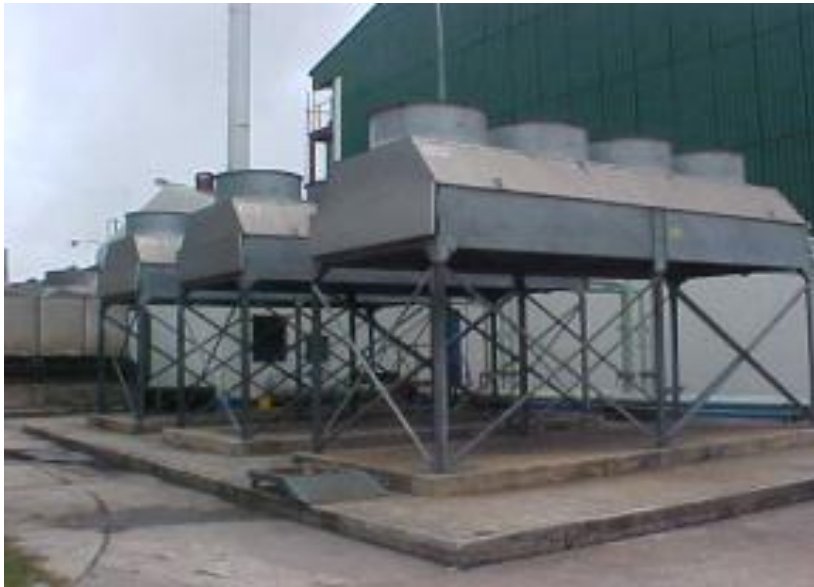
Figura N° 34 Enfriadores de los Grupos Wartsila
