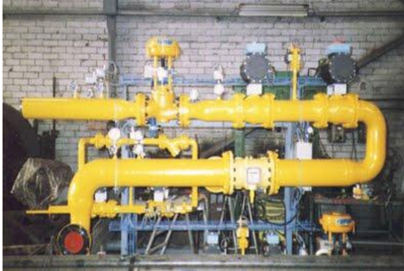
Figura N° 27 Estación de Regulación y medición de Gas Natural Fuente: EGESUR
